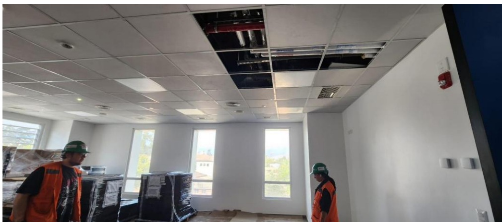
Localización de la infiltración de fluidos
